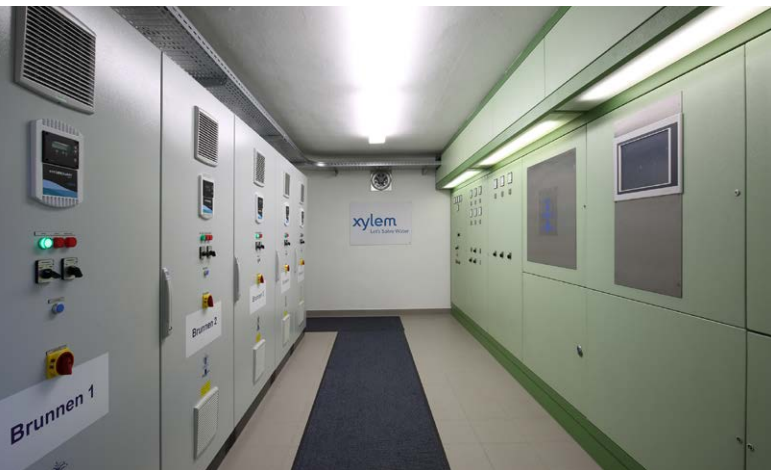
Schaltkästen in der Pumpstation
