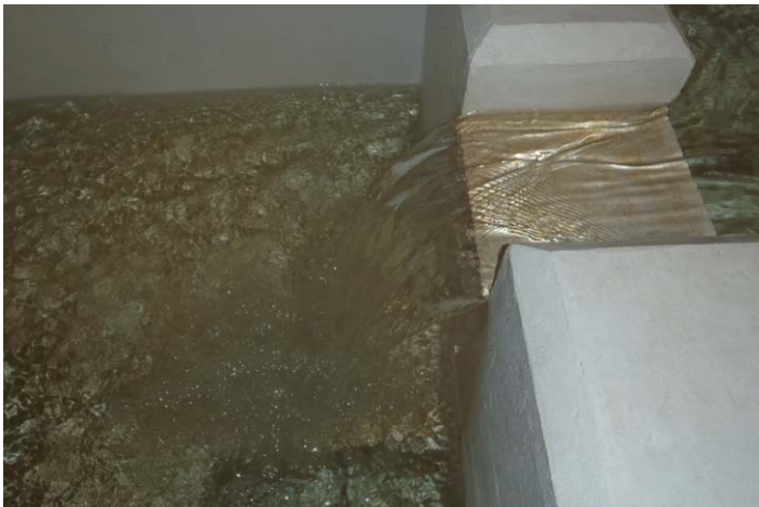
Einlauf vom Sandfang in die Reinwasserkammer
