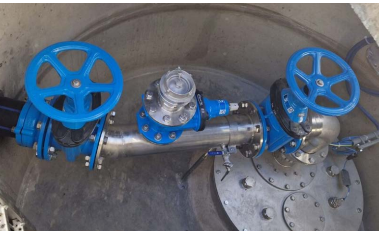
Großvertikalfilterbrunnen Installation im Brunnenschacht
