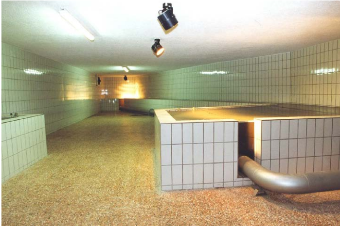
Vorkammer mit Zustiegsmöglichkeit zu den beiden Speicherkammern des Behälters
